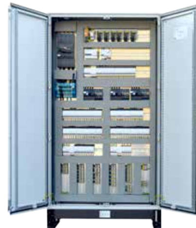
In het gebouw staan een zestal elektrische borden.
